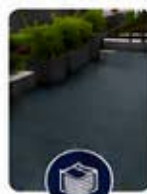
TERRAÇOS E LAJES EXPOSAS
